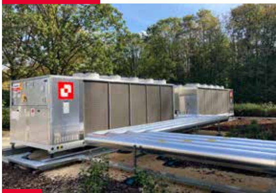
De warmtepompen verwarmen het gebouw en de watervoorziening met 100% groene stroom.
